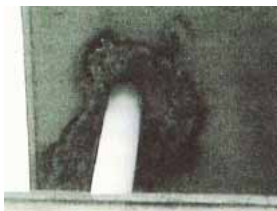
軒裏 雨漏りの跡
