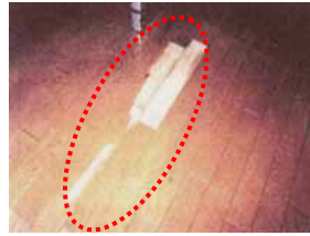
床 大きな欠損
