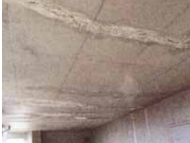
天井 ひび割れ
