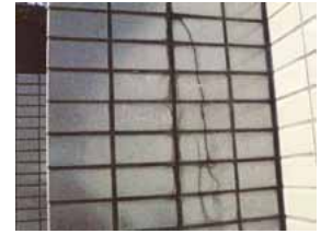
外壁 タイルのひび割れ
