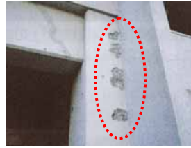
柱・はり 大きな欠損
